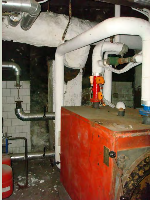
Amianto a matrice friabile materiale isolante tubature
