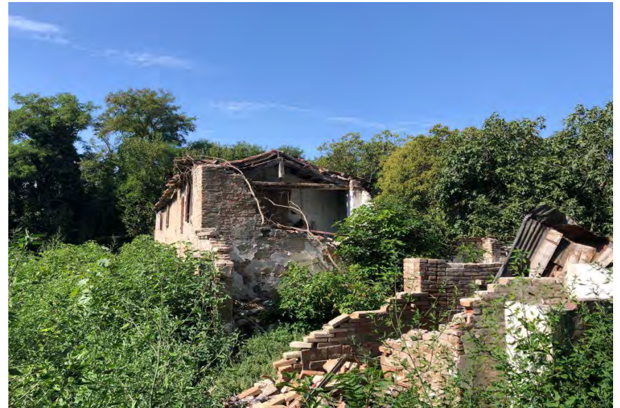
Porzioni crollate dell'abitazione
